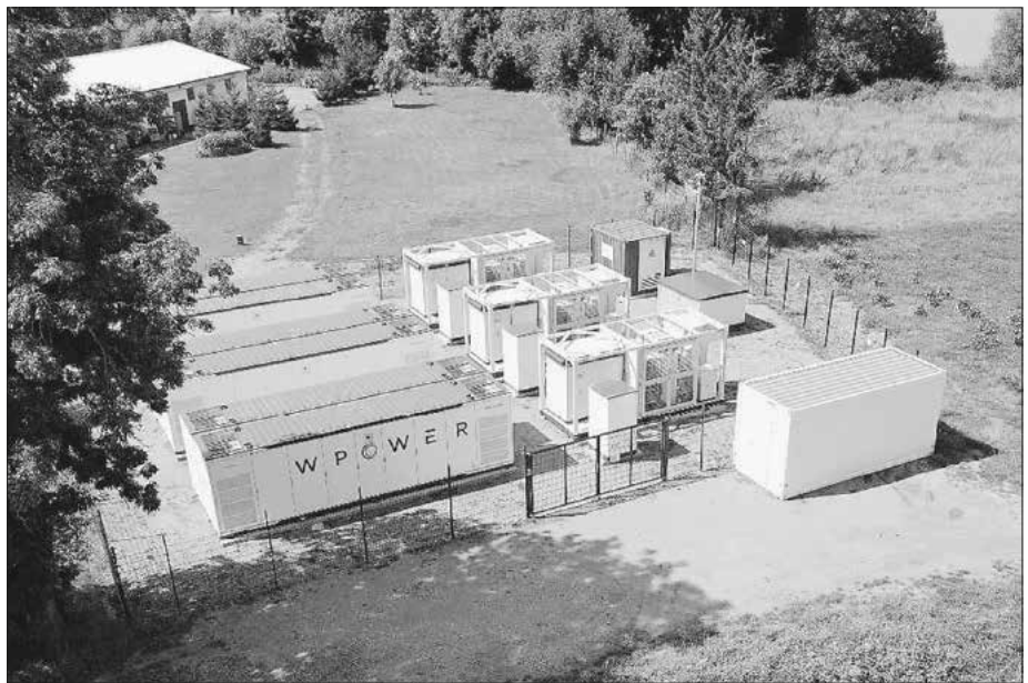
Beispiel 10-MW-Batteriespeichersystem, Thüringen
